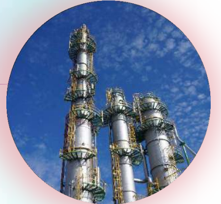
苦小牧CCS実証試験センター 分離・回収設備
