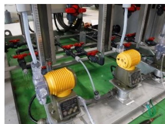
純水設備薬注ポンプ点検
