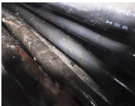
加熱損傷ケーブル
