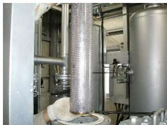
ドライヤーフィルター交換
