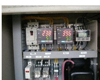
フレアバーナー点火昇温確認
