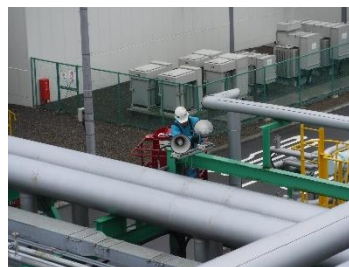
放送設備点検
