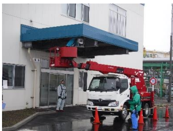
監視カメラ点検
