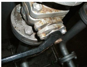
ドライヤー弁不良（亀裂）
