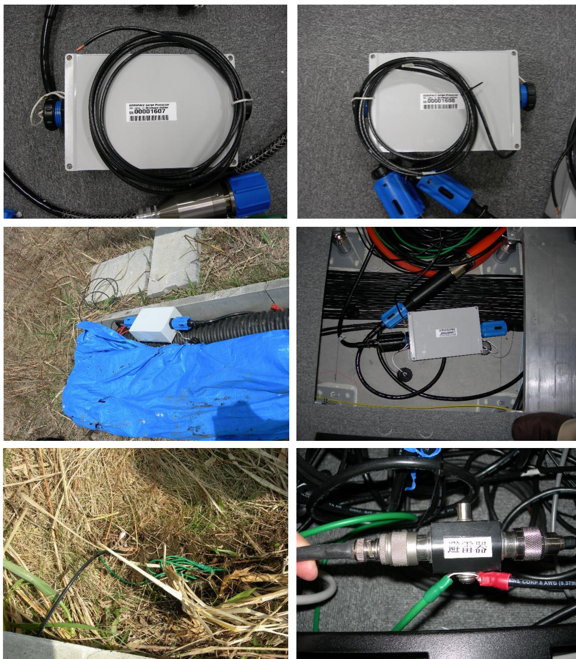
図 4.3-16 雷防護装置の設置時の様子（上左：S/N1607、上右：S/N1608）
