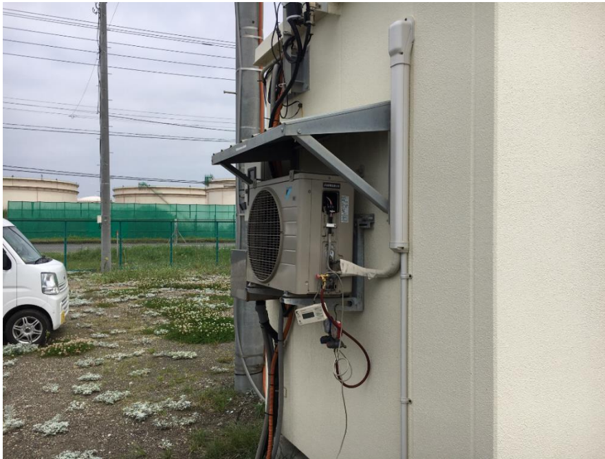
図 4.1-30 修理した OB-2 観測ハウスのエアコンの室外機
