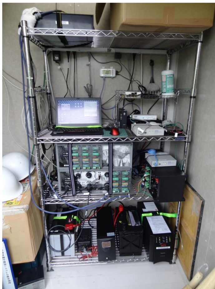
図 4.2-5 観測小屋に収納されたデータ収録関連機器（交換後）
