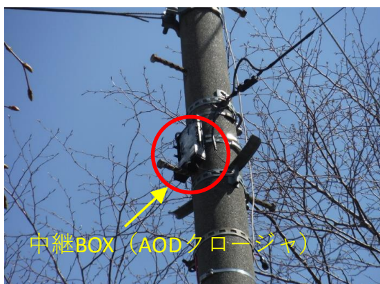
カバーがはずれた状態の中継BOX
