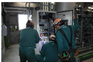
純水設備制御盤点検
