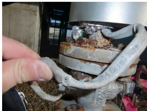
図 2.2-5(2) 電気トレースケーブル損傷
