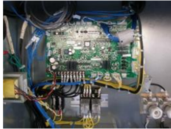
圧縮機制御盤点検
