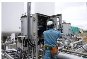
現場制御盤検査
