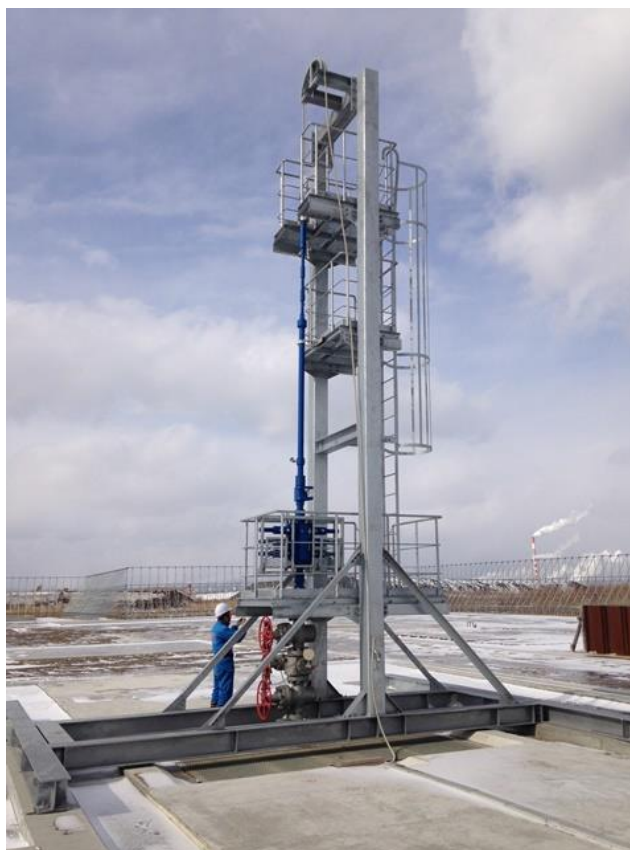
図 4.1-14 OB-1 に設置した坑口装置保持鉄塔および作業用足場
