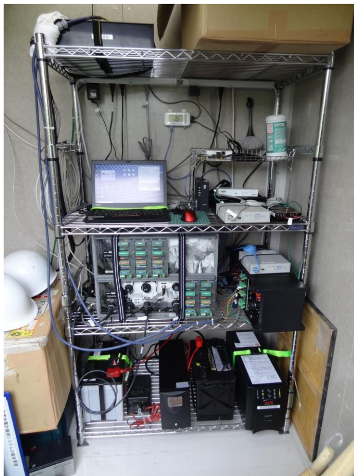
図 4.2-5 観測建屋に収納されたデータ収録関連機器（交換後）
