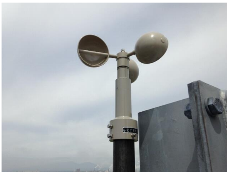
図 4.1-16 坑口装置保持鉄塔に設置した風速計
