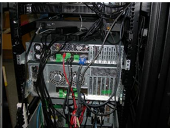
図 4.3-11 NAS サーバ取付状況(背面)
