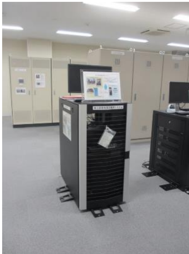
図 4.2-6 実証試験センターに設置されたデータ収録サーバ等
