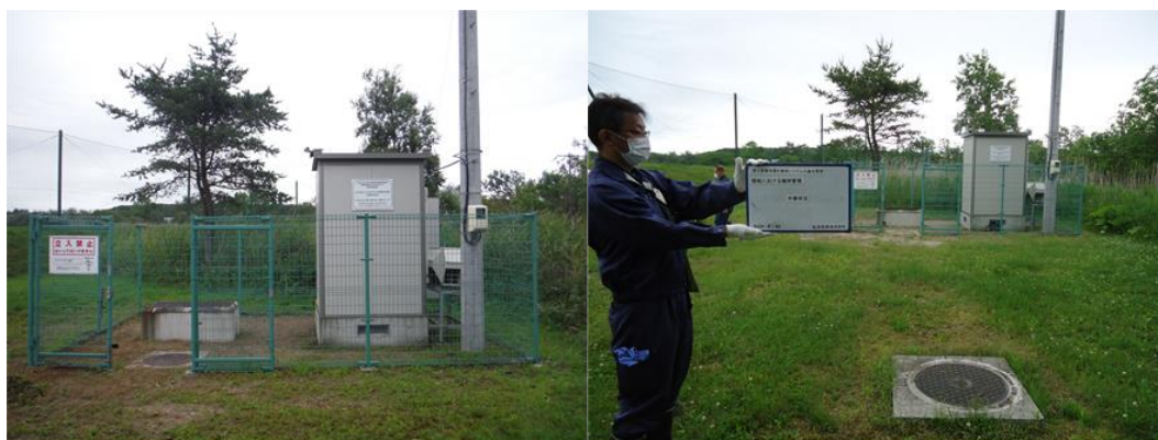
図 4.2-10 現地観測施設の全景（左；近景、右；アンカーマンホール含む）
