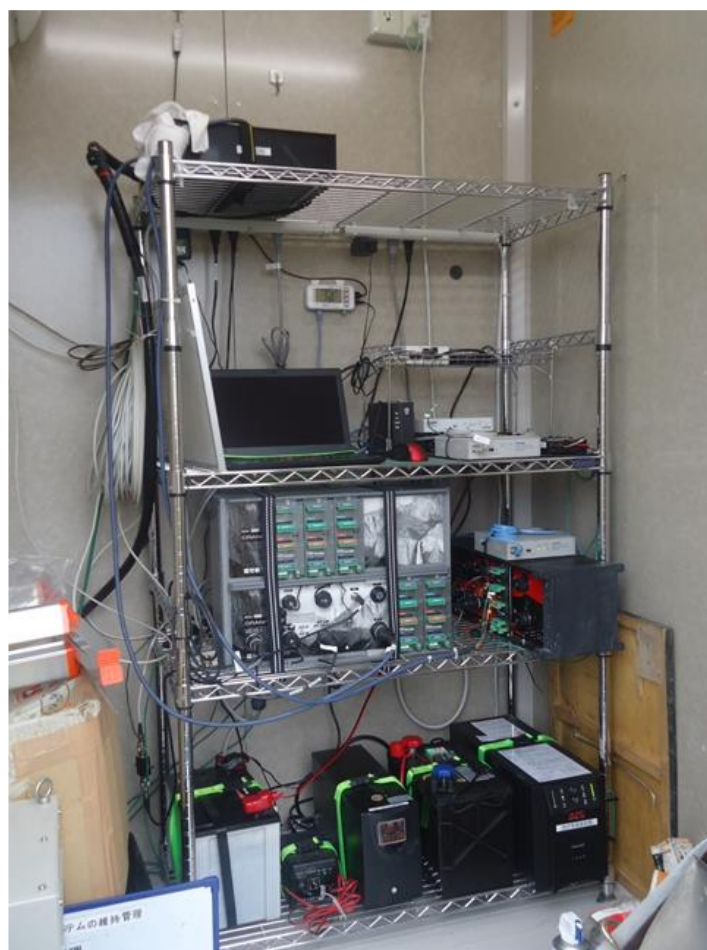
図 4.2-5 観測建屋に収納されたデータ収録関連機器
