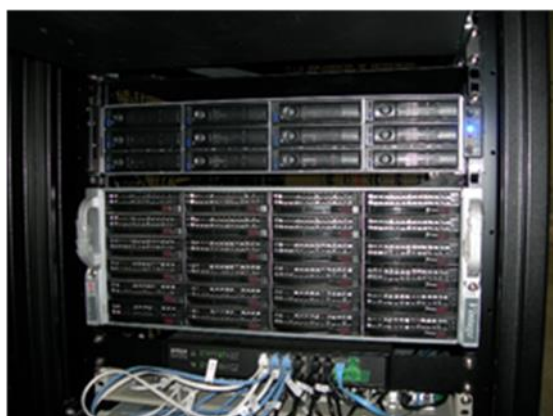
図 4.3-12 NAS サーバ取付状況(前面/上段)
