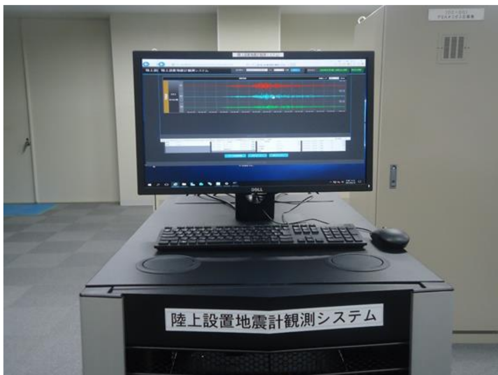
図 4.2-7 データ処理・監視ソフトウェアによるモニタリング画面
