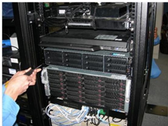
図 4.3-10 NAS サーバ取付状況(前面/中段)
