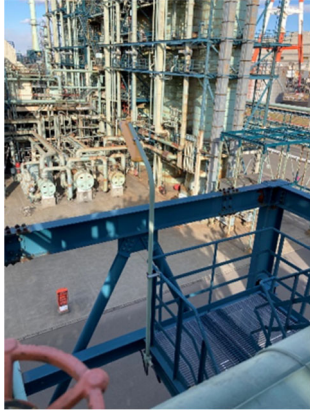
図 2.1-8 外灯修理前状況
