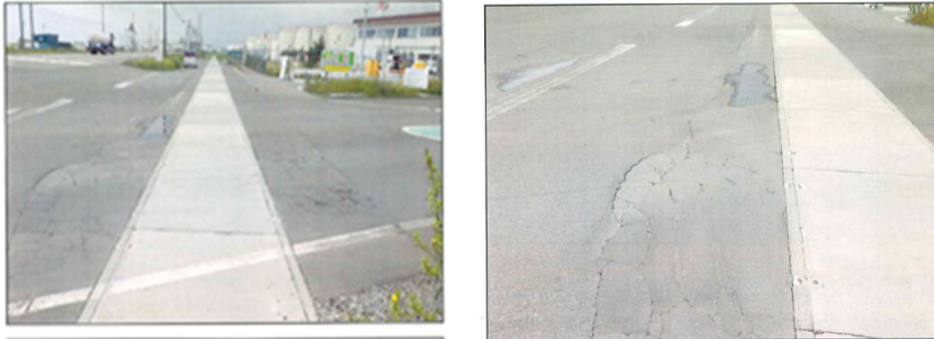
図 2.1-2 補修前の不具合箇所(アスファルト部のひび)
