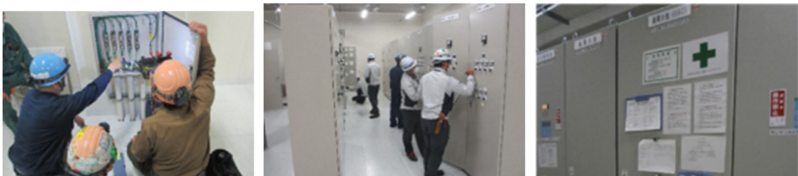
無電圧確認 制御盤点検 無停電電源装置点検
