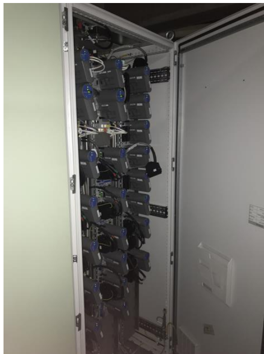
図 2.1-7 現場に設置された更新 DCS 装置内部の様子
