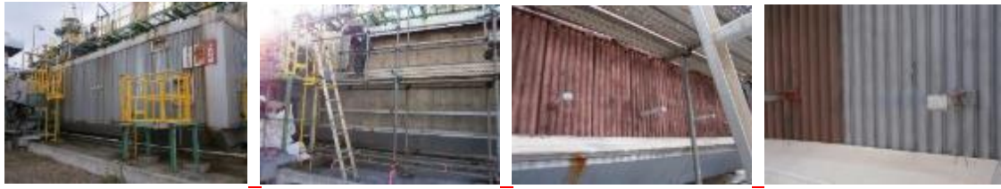
工事前の外観 外側ケーシング取外し ボイラーチューブ ブラスト処理中（右側）
