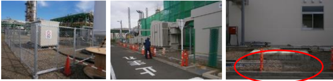
仮設電源設備設置 既設変圧器撤去準備（フェンス撤去） 既設変圧器撤去後の基礎
