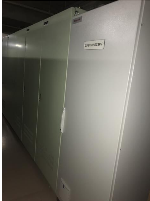
図 2.1-6 現場に設置された更新 DCS 装置外観
