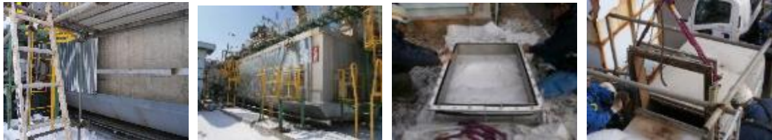
高圧ボイラーケーシングの外板更新工事 新エキスパンション 既設取外し工事
