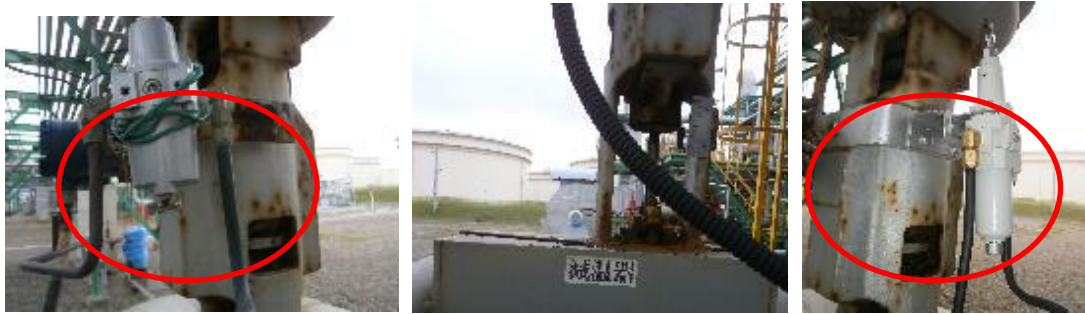
計装空気レギュレーター取付け金具腐食折損
