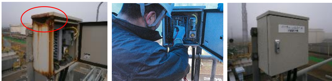
腐食開口した端子箱
