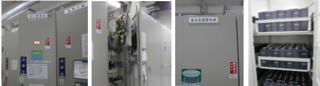
直流電源装置の点検 同左 無停電電源装置の点検 バッテリー点検
