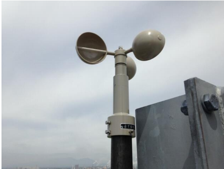
図 4.1-17 坑口装置保持鉄塔に設置した風速計
